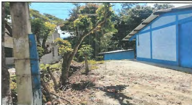
Foto 2: En esta fotografía se observa erosión provocada por la quebrada, en la entrada al centro educativo y se mejorará con muro de contención-
